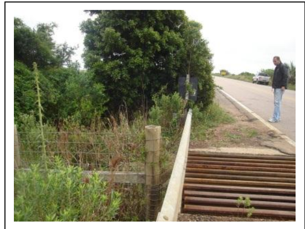
Figura 97. "Mata-burro" instalado para evitar a entrada de animais no segmento cercado. BR 471/RS, Santa Vitória do Palmar. Foto: José Antonio Palmeiro Gudolle, NLA/IBAMA/RS.
