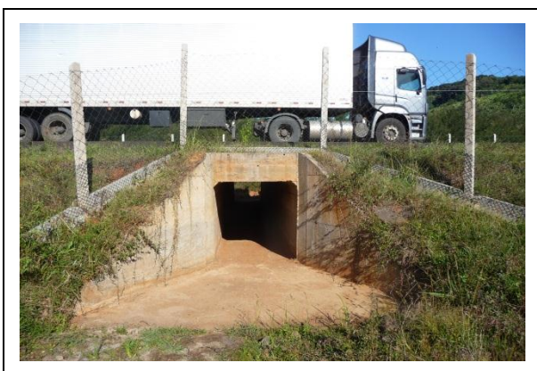
Figura 20. Passagem de fauna em bueiro celular 1,5 x 1,5 m, BR 101/RS.
