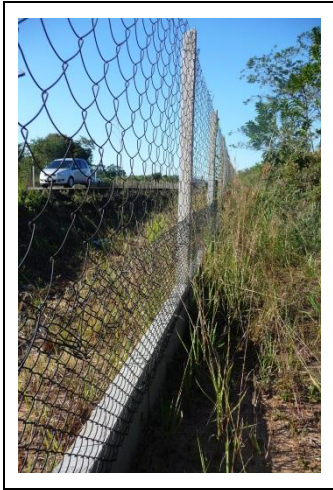
Figura 94. Cerca com base em concreto e tela em malhas progressivas. BR 101/RS.
