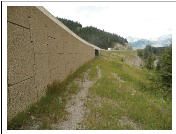
Figura 96. Solo estabilizado mecanicamente, por meio de geogrelhas estruturais, servindo como cerca direcionadora (CLEVINGER & HUIJSER 2011).
