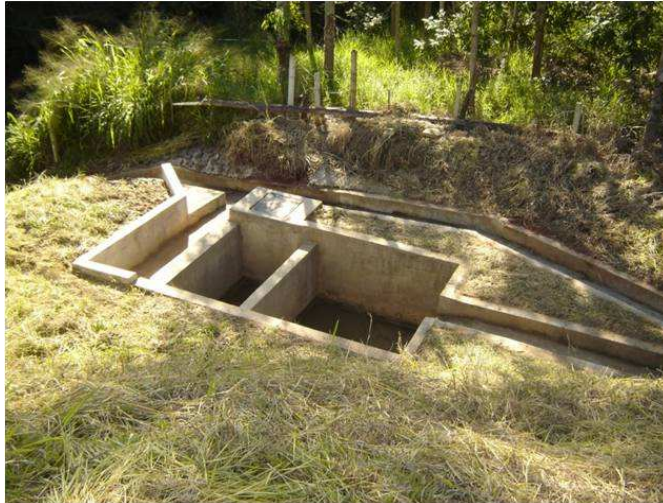
Foto B8 – Concessionária Colinas Fonte: Arquivo da Cetesb, emergências, 2010.
