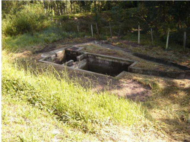
Foto B7 – Concessionária Colinas Fonte: Arquivo da Cetesb, emergências, 2010.
