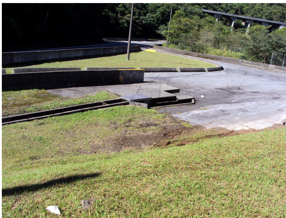
Foto 9 – Caixa de contenção no pátio do “paradouro” da Rodovia Anchieta. Fonte: Elaborado pelo autor.
