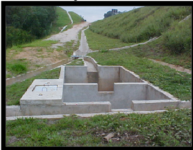
Foto B14 – Rodovia Dr. Celso Charuri - SP - 091/270, Concessionária Via Oeste. Fonte: Arquivo da Cetesb, emergências, 2010.
