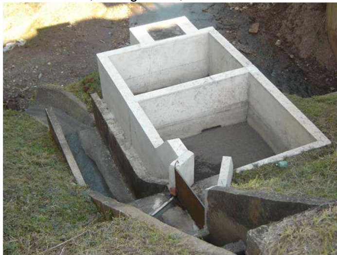
Foto B9 – Concessionária Colinas Fonte: Arquivo da Cetesb, emergências, 2010.
