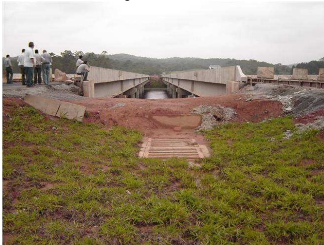
Foto B17 – Rodoanel Mario Covas – Trecho Sul. Captação de canteiro central. Dersa. Fonte: Arquivo da Cetesb, emergências, 2010.
