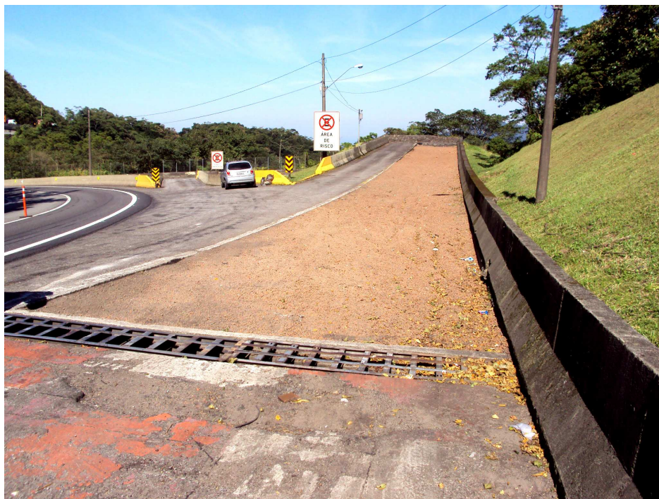
Foto 8 – Detalhe do “paradouro” na Rodovia Anchieta, detalhe da caixa de brita para a imobilização emergencial de veículos desgovernados. Fonte: Elaborado pelo autor.
