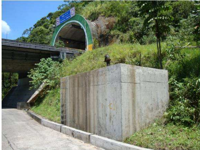
Foto B16 – Rodovia dos Imigrantes - Pista Descendente. Captação de pista na saída do túnel e caixa estanques nas saídas dos túneis. Concessionária Ecovias. Fonte: Arquivo da Cetesb, emergências, 2010.
