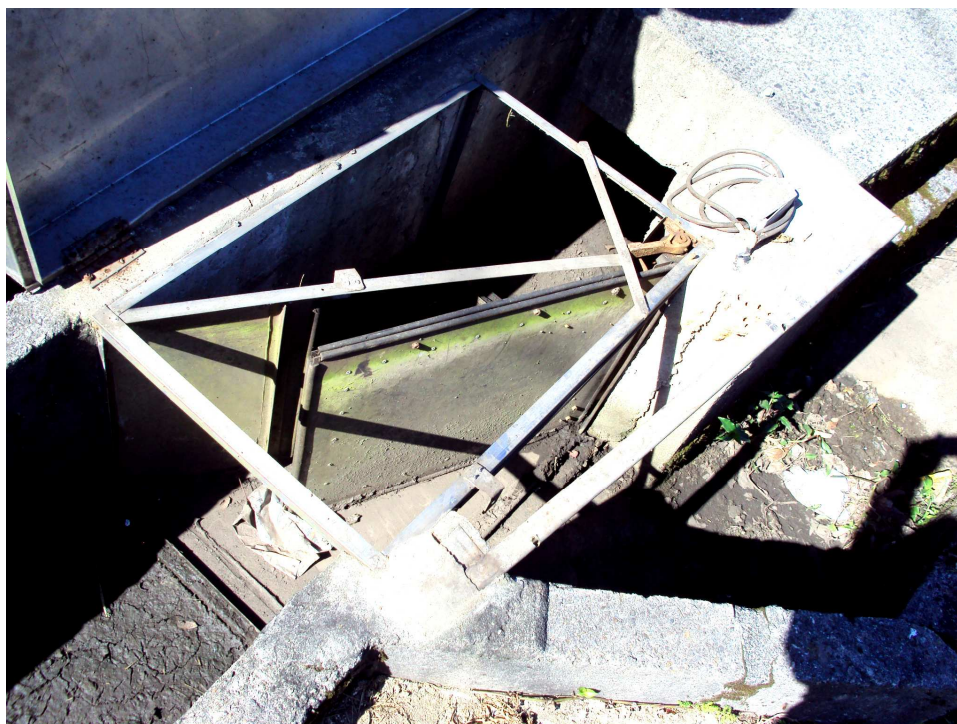
Foto 11 – Detalhe do mecanismo de separação, “bypass” na caixa de contenção do “paradouro” da Rodovia Anchieta. Fonte: Elaborado pelo autor.
