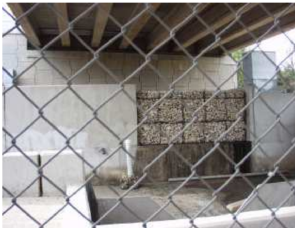
Foto A4 – Texas, EUA. Bacias e filtros na “ MoPac, Gaines Creek Bridge ”. Fonte Landphair, Mcfalls & Thompson, 2000;
