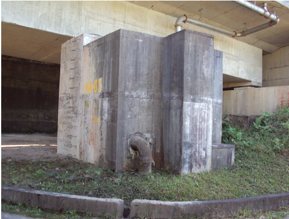
Foto 01 – Caixa de produtos perigosos, instalada na estrada de serviço, sob a pista descendente da Rodovia dos Imigrantes. Observa-se a tubulação de entrada fixada à obra de arte.
