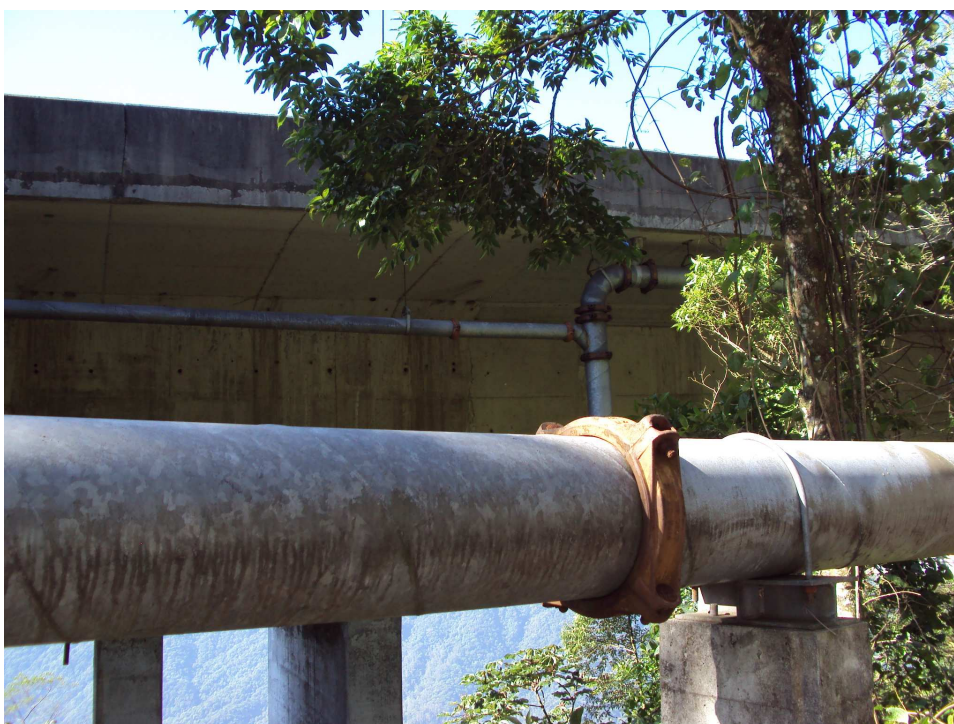
Foto 15: Pista descendente da imigrantes. Segregação de drenagem. Captura e destinação da drenagem de pista. Fonte: Autor.
