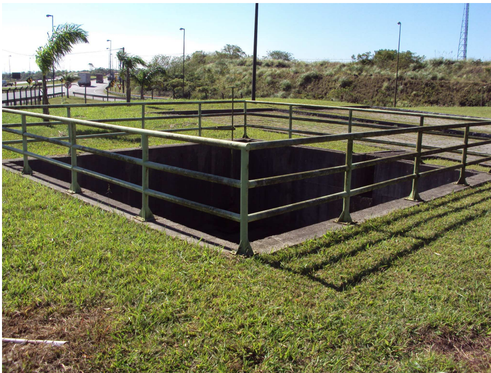
Foto 02 – Caixa de produtos perigosos, em pátio de caminhões no entroncamento da Rodovia Anchieta com a interligação para a rodovia dos Imigrantes.
