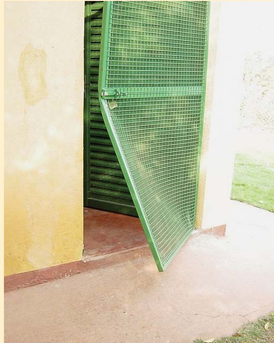
Porta arrombada da sala de recepção
