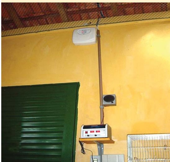
Sistema de alarme instalado
