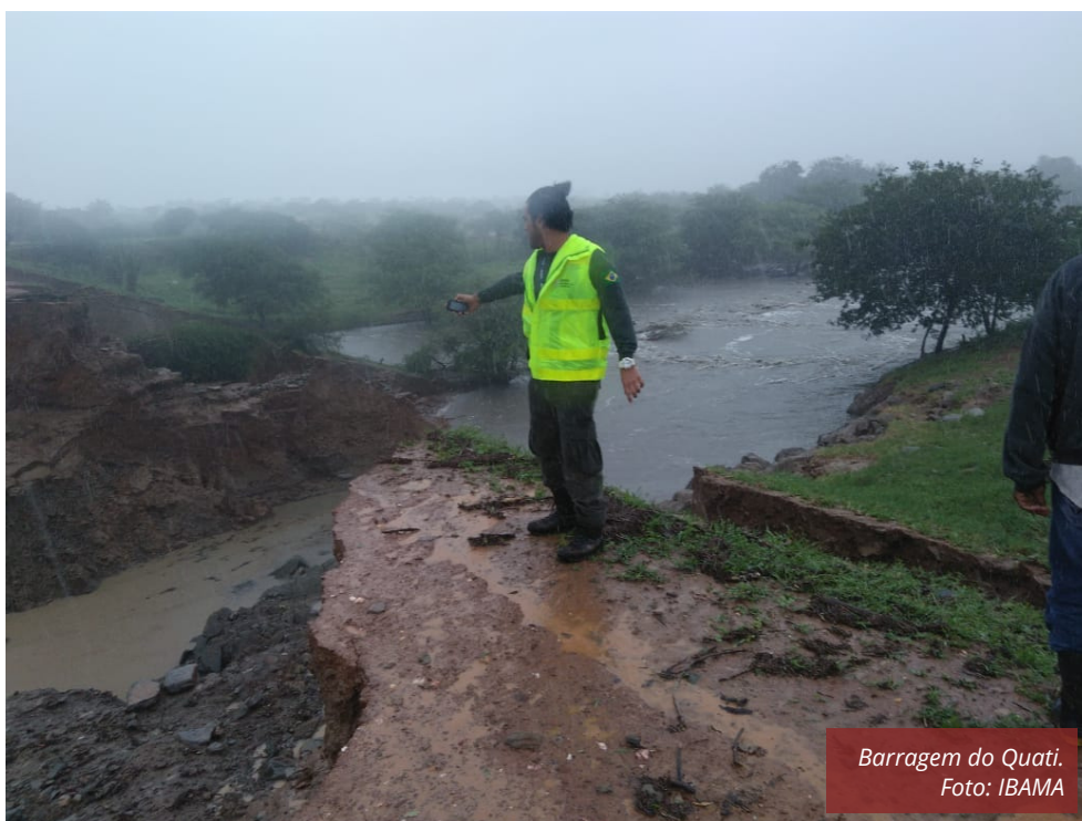
Barragem do Quati após rompimento. Foto: GRAER / PMBA
