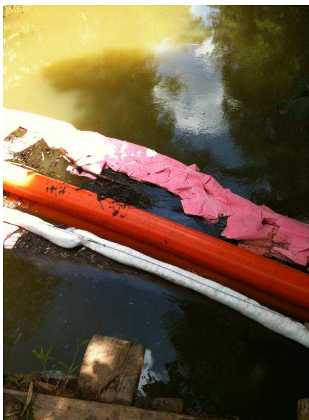
Figura 23: Barreira de contenção e absorventes posicionadas no local de captação de água.
