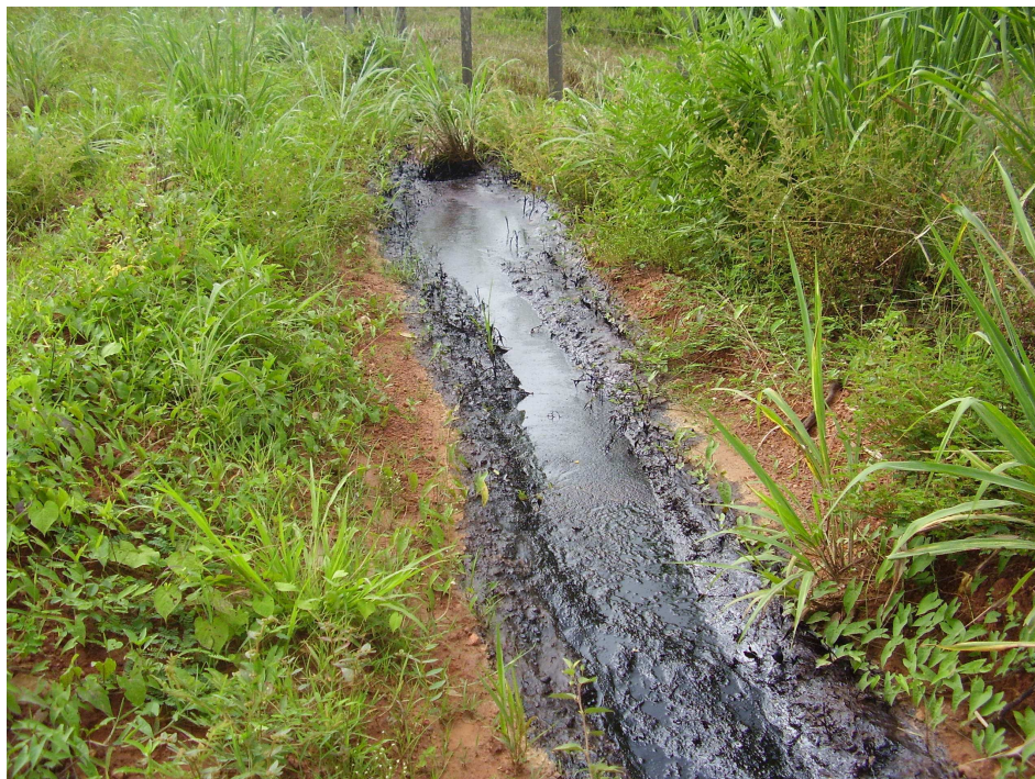
Figura 25: Material betuminoso escorre próximo a área de vereda. (Foto tirada pela Funasa).
