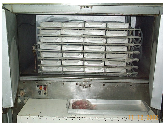
Figura 19 – Congelamento em armários de placas a -25 a -40 °C.
