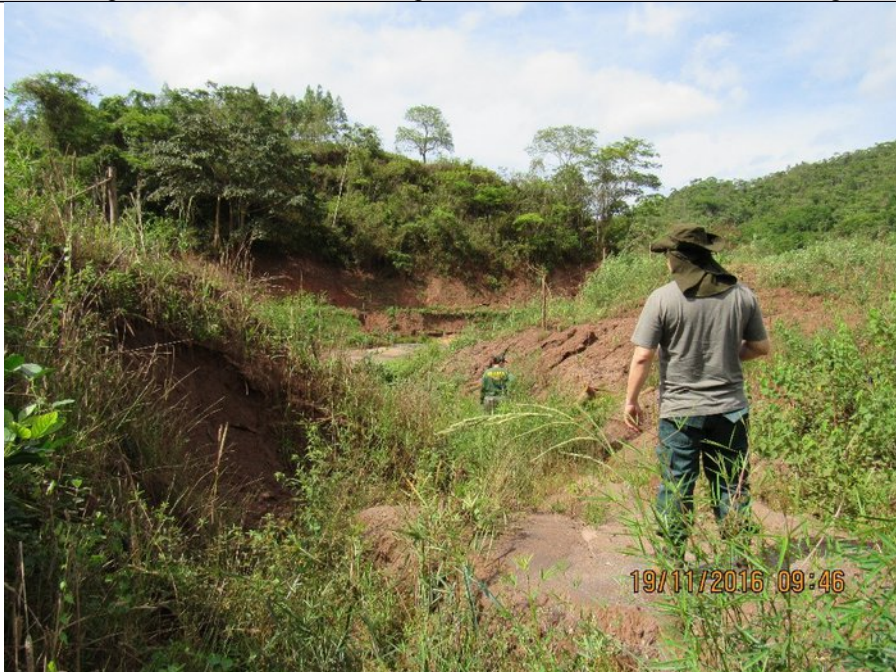
ITG 30 (2): Leito reconformado do tributário ITG 30, abaixo da estrada de acesso, que foi escavado no rejeito depositado. Abaixo, acúmulo de rejeito no leito reconformado. Ao fundo, processo de ravinamento do talude da margem esquerda do leito reconformado.
