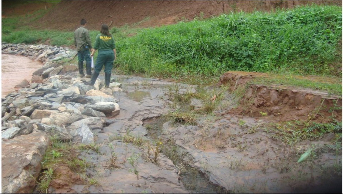
NTG 07 (4): À esquerda, enrocamento instalado pela Samarco bloqueando a foz do tributário NTG 07. Ao centro, vala aberta no rejeito pela força d'água do tributário NTG 07. Acima, margem esquerda da foz ocupada por capim exótico seguindo de talude desprotegido da estrada com acúmulo de rejeito e sinais de ravinamento.
