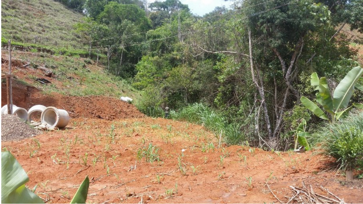
ITG 34 (1): Detalhe de APP e parte do curso do tributário ITG 34 (TG 28) aterrado em área localizada acima da estrada de acesso a nova sede da propriedade atingida. Nota-se o plantio de milho na área aterrada. À esquerda e ao centro, manilhas de concreto e brita excedente da obra de canalização do tributário para construção da estrada de acesso e direcionamento do escoamento para passagem de nível construída.
