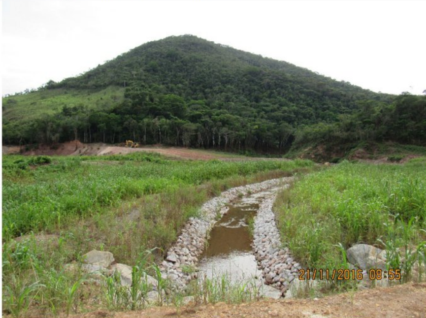
ITG 24 (2): Vista do leito reconformado do tributário ITG 24, com enrocamento contínuo nas duas margens e vegetação desenvolvida sobre biomanta (mix de sementes). No entorno da margem esquerda, nota-se o desenvolvimento de gramíneas exóticas, enquanto que, no entorno da direita prevalece o desenvolvimento das espécies do mix de sementes.
