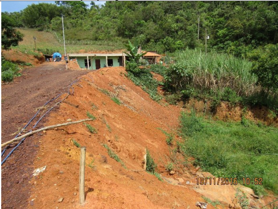
ITG34 (2): Estrada de acesso a nova sede da propriedade (ao fundo) no ponto onde cruza o tributário ITG 34 (TG 28) Detalhe do rejeito sobreposto a faixa de rodagem (cor escura) e talude sem qualquer vegetação ou intervenções para mitigação da erosão. Abaixo (à direita), saída da passagem de nível construída para canalização do tributário.
