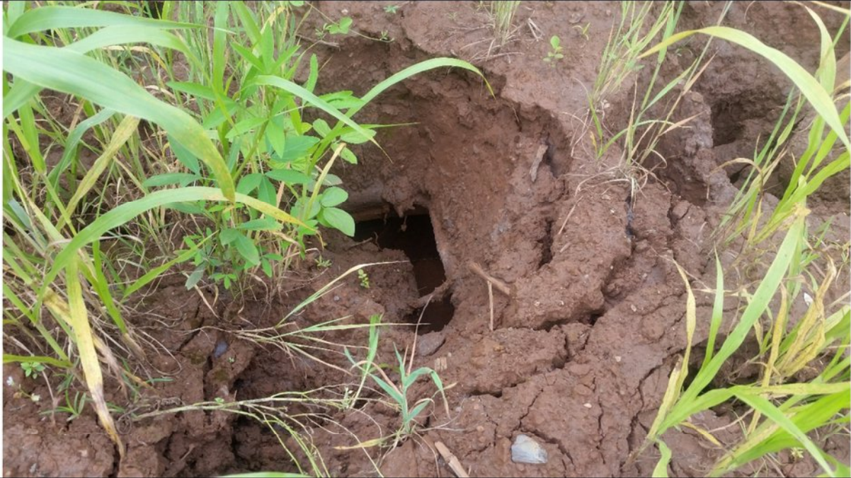
ITG 24 (3): Detalhe buraco oriundo de erosão do tipo piping em uma área localizada na margem direita do tributário ITG 24, próximo ao rio principal.
