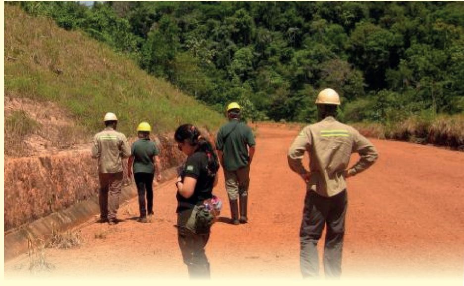
Acompanhamento da recuperação de talude – Mineração Sacará. Foto: Julio Henrichs de Azevedo.
